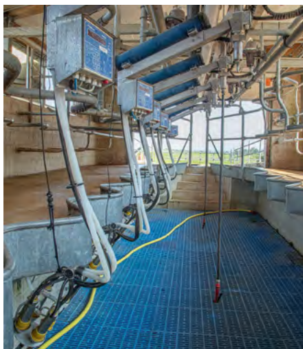
Ein Teil des 16er-Swing-over-Melkstands mit Blick auf den Warteraum.
